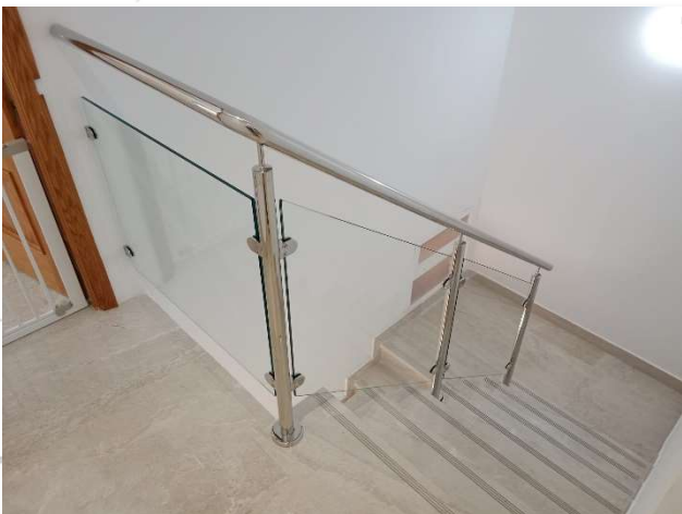
Barandilla inox con vidrios
