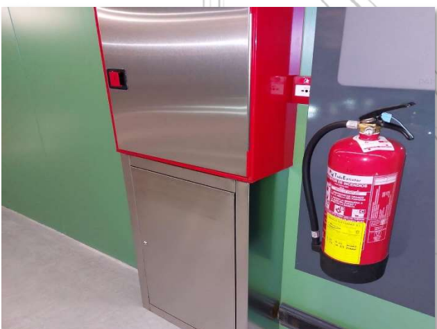
Puertas armarios de servicios
