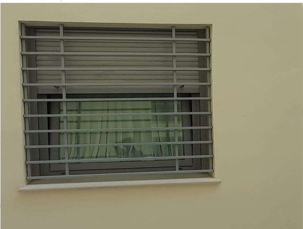
Rejas de seguridad
